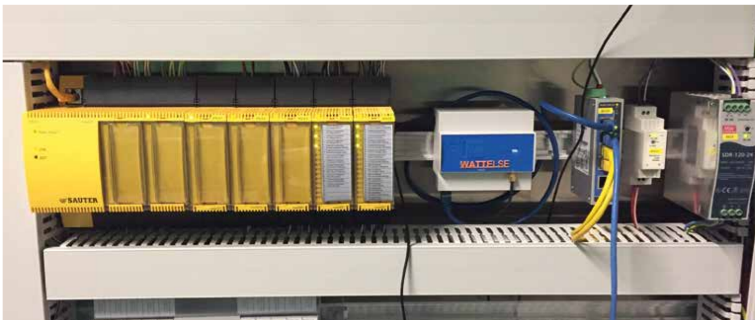
Das Gateway von Wattelse zur Sammlung aller notwendigen Daten wird über die Projektlaufzeit in den Schaltschrank eingebaut.
